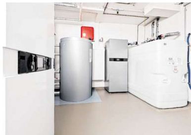
Doppelt wertvoll: die Kombination aus Brennwertheizung und einem Speicher, der regenerativ gewonnene Energie bevorratet.
